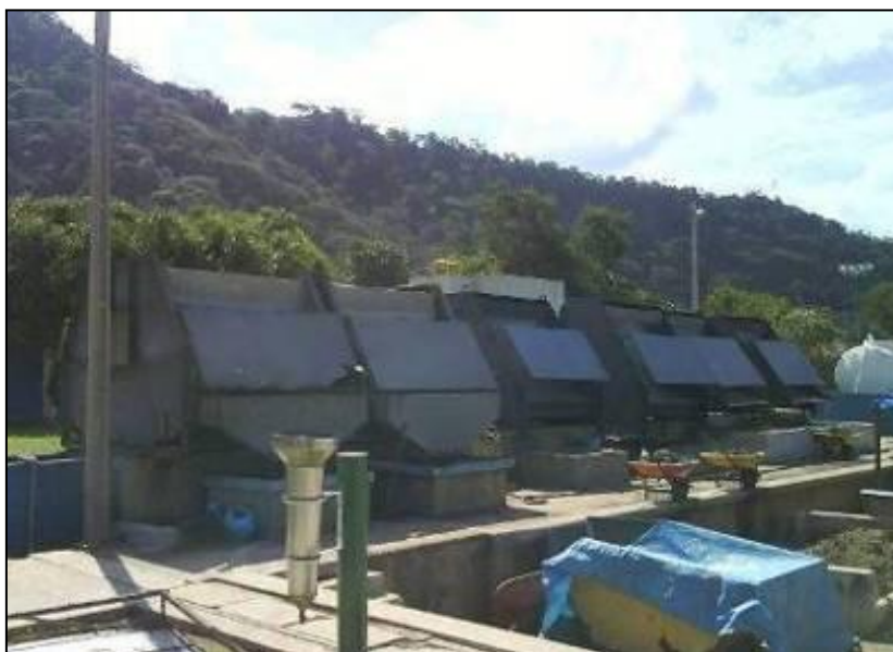
Foto 12 – Estação de Pré-Condicionamento Itatinga
