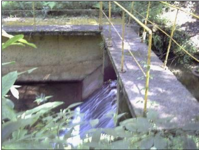
Foto 03 – Captação no Rio Guaecá
